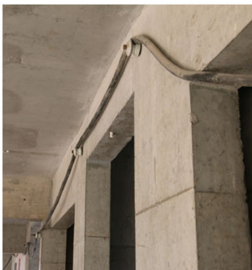
楼内电缆线悬挂于瓷瓶上
