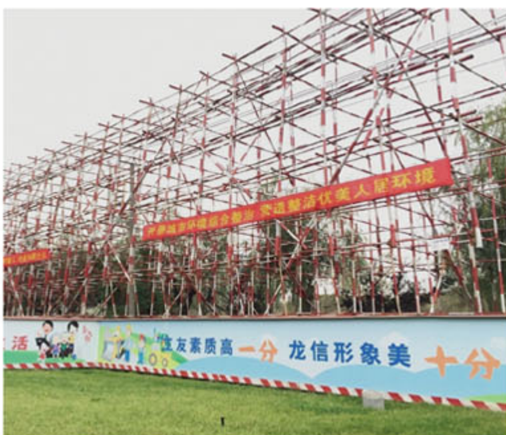
高压电线防护架
